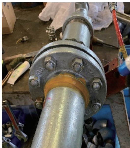
R 2 バンドを使用して、ガス漏れ修理後、完全にガス漏れが止まる事を確認しました。
